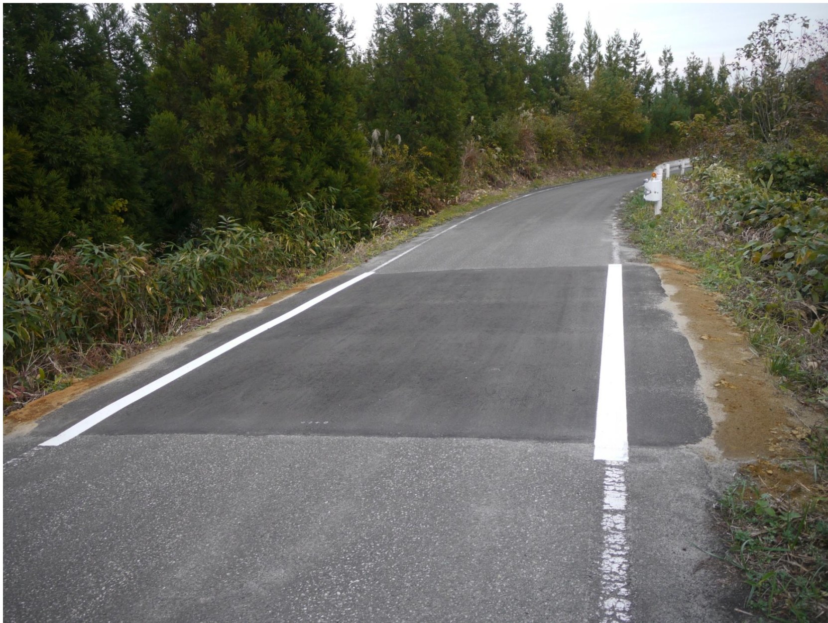
InSARのLOS急変部付近で見つかった道路改修跡(花山地区)
